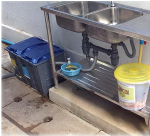
ภาพที่ 6-16 ตัวอย่างการติดตั้งบ่อดักไขมันบริเวณพื้นที่ล้างจาน ของการไฟฟ้าส่วนภูมิภาค อำเภอบัวใหญ่
