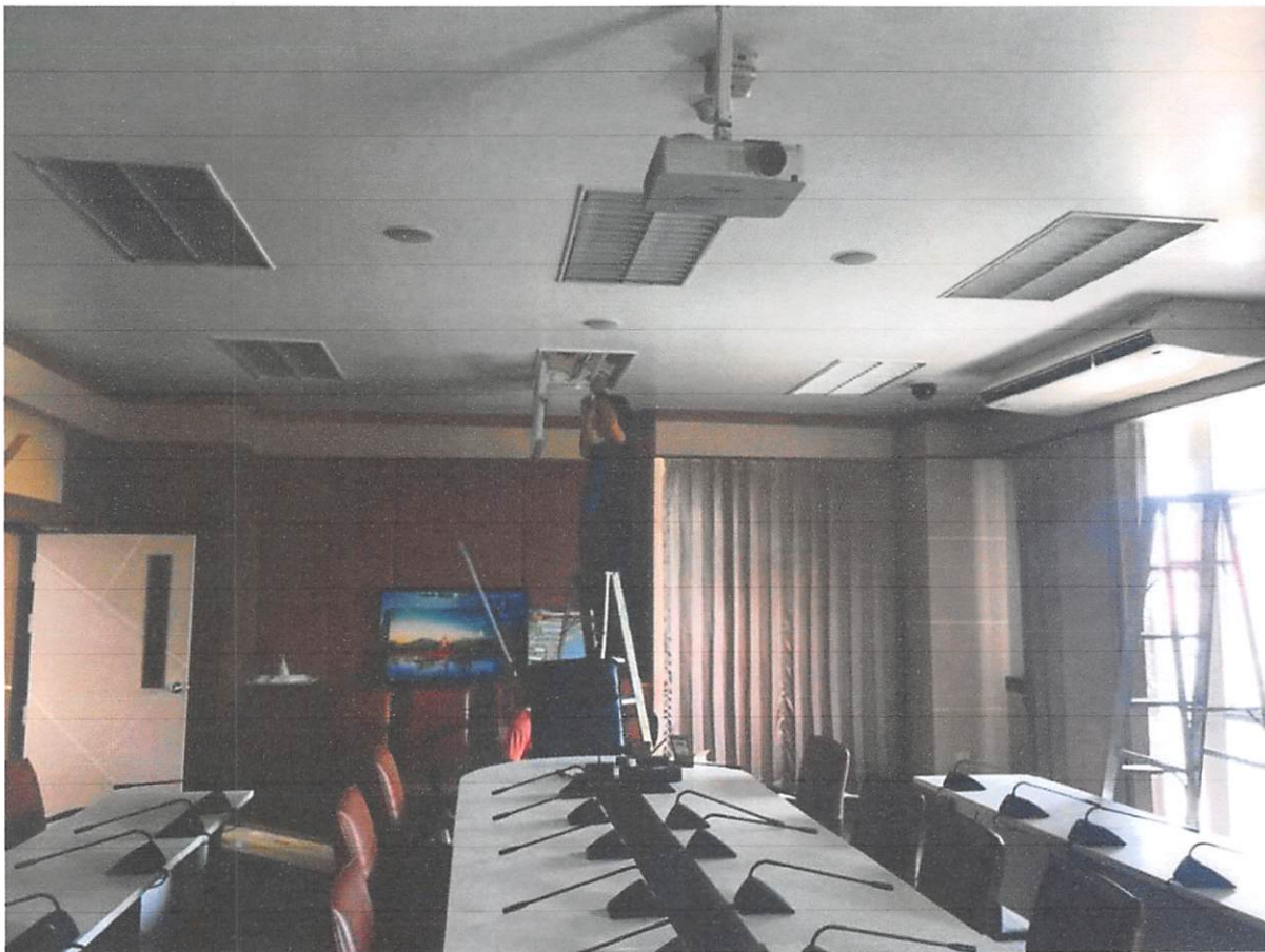
ภาพการเปลี่ยนหลอดฟลูออเรสเซนต์เป็นหลอดประหยัดพลังงาน LED เพื่อให้แสงสว่างภายในอาคาร ๑๔
