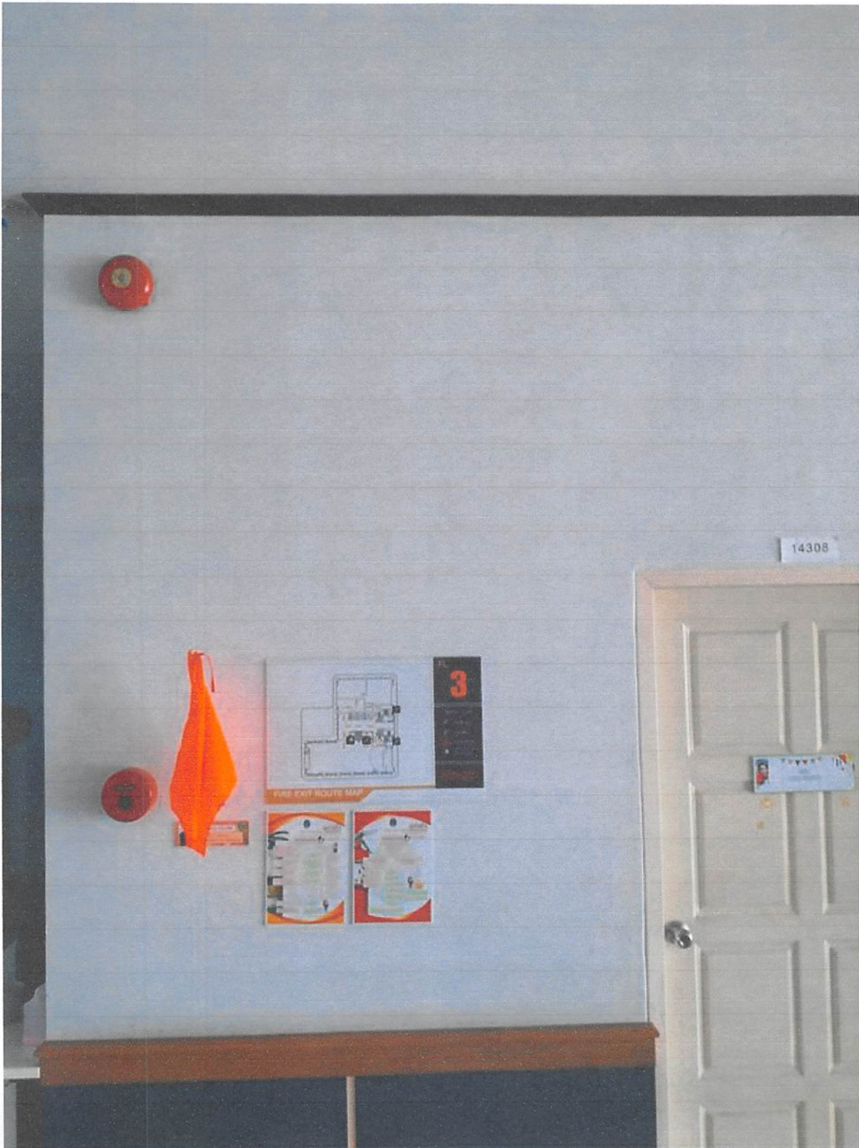
ภาพ ระบบสัญญาณแจ้งเหตุเพลิงไหม้ (ต่อ)
