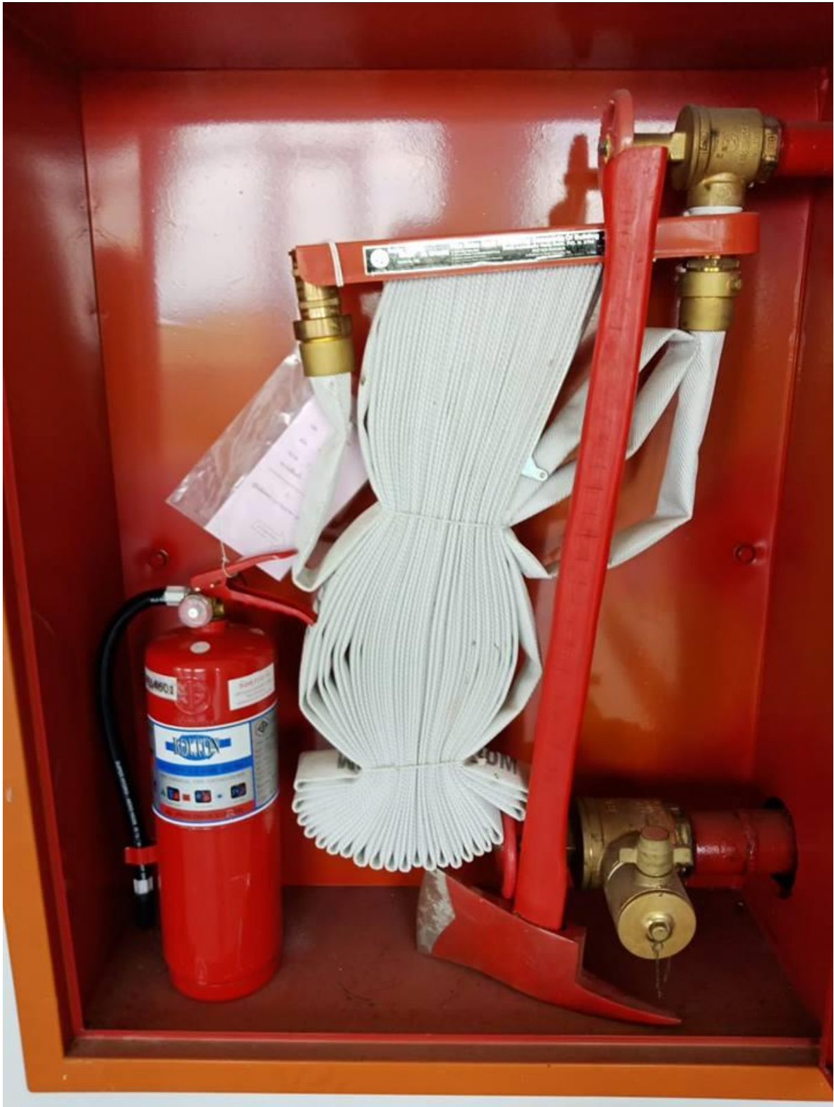
ภาพ เครื่องดับเพลิงแบบเคลื่อนย้ายได้ (ต่อ)
